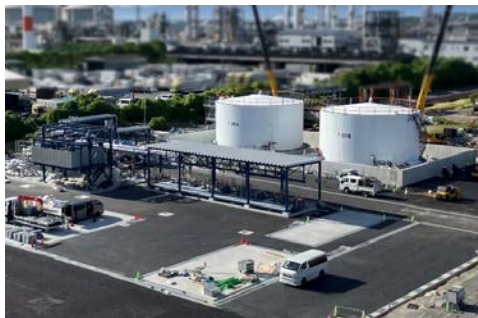
原料（廃食用油）の受け入れ設備
